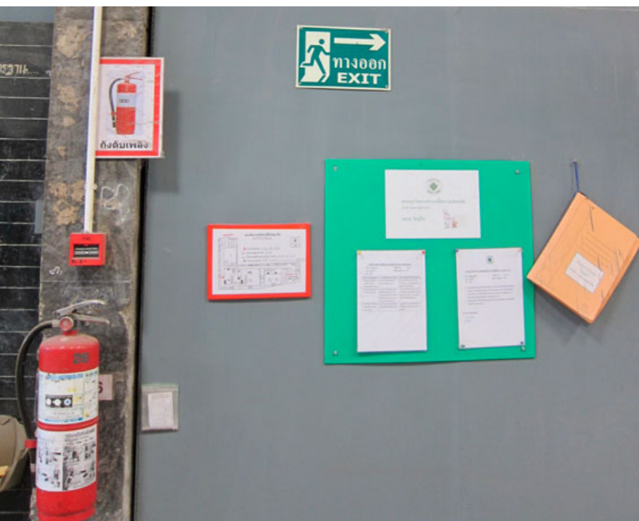
Finnwatchin raportin jälkeen tehtaalle on asennettu erillinen palohälytysjärjestelmä ja merkitty hätäuloskäyntejä.
